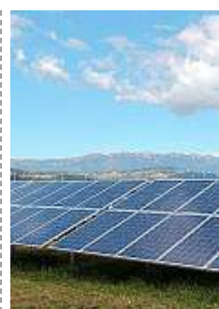
Il parco fotovoltaico di Orsara
